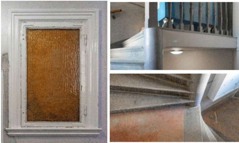
Bilder. Interiörbilder från trapphuset i flygelbyggnaden inom Doppingen 2, som visar ett före detta invändigt fönster, trappa med trappräcke (WSP 2017).
