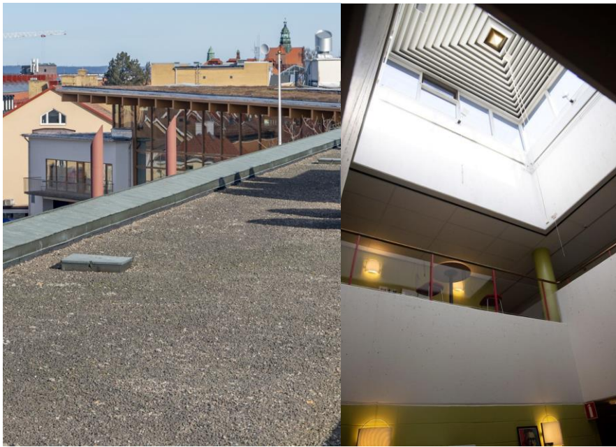
Bild. Till vänster. Landsstatshusets platta tak med kopparsarg. Till höger. Ett av ljusschakten med taklanternin. I bilden syns även den konstnärligt uppförda ljudabsorbenten samt de ursprungliga räckena som finns i ljusschakten.
