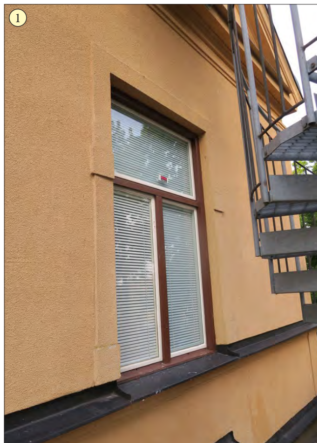
1: En modell av de fönster som troligen sattes in på 1960-talet och som mer ska likna originalfönstren, men saknar mittpost i den liggande rutan.
